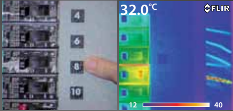
Collegamenti difettosi, invisibili all'occhio umano, ma individuabili chiaramente sull'immagine ad infrarossi.
